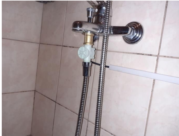
Fig. 24 Senzor de debit instalat la bateria de duș
