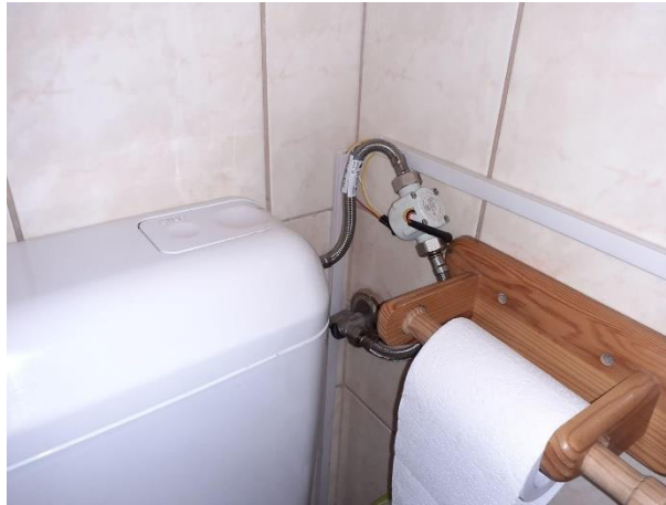
Fig. 26 Senzor de debit instalat la alimentarea cu apă a toaletei
