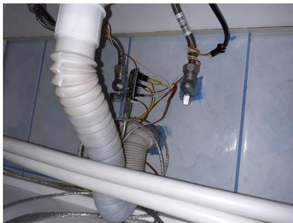
Fig. 25 Modul de achiziție instalat sub chiuvetă
